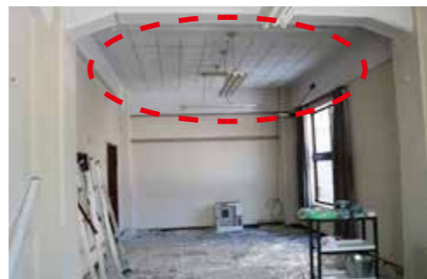
汚れが目立つ天井にペンキを塗りました(上=Before、下=After)
