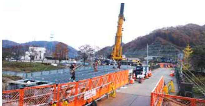
工事が進む沢山橋。既存の橋は歩行専用の橋として残す予定です
