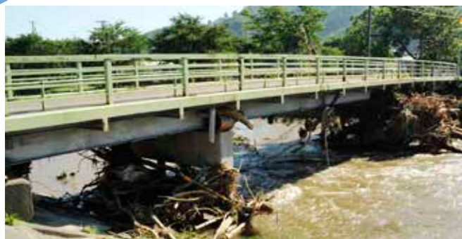
昨年8月の台風10号の影響で橋脚が流出した羅賀橋
