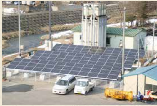
役場職員駐車場に設置された太陽光発電のソーラーパネル
