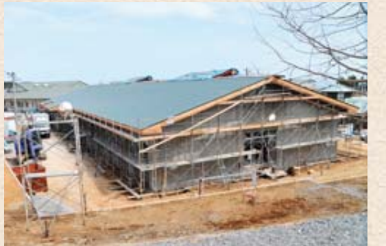
30床の増床の工事が進む特別養護老人ホーム「うねとり荘」(鳥居地区)
