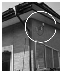
外壁に付けたアンテナ
