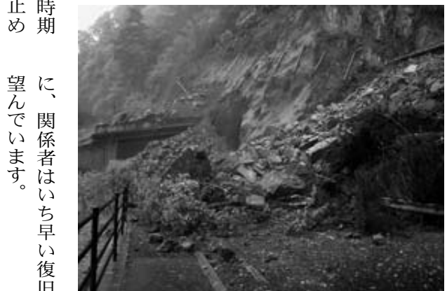
大きく崩壊したのり面（5月27日建設水産課撮影）
