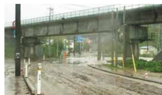
台風第19号災害で冠水した普代インターチェンジ付近
