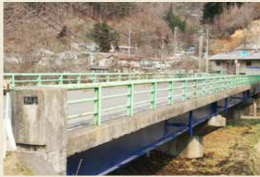
村道や各橋梁などの老朽化対応を施します (本年度補強工事を予定する普代橋)
