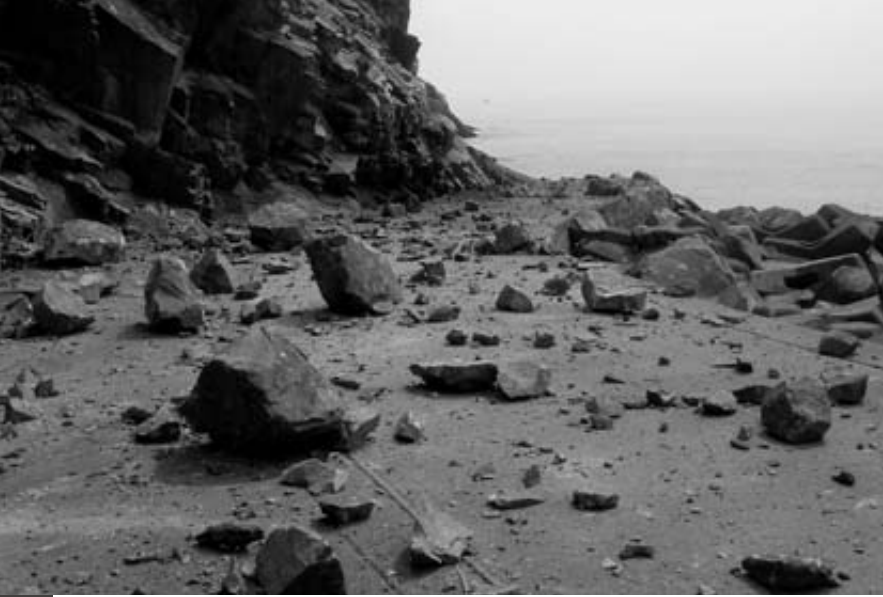
普段は釣り人が多い普代浜の北側。斜面から崩れた岩が散乱し道路が覆われました＝24日午前9時2分
