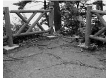
黒崎灯台周辺のさくも一部決壊＝24日午前11時
