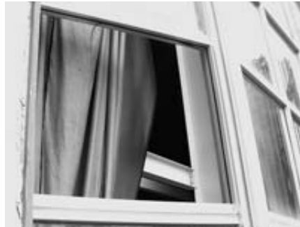
ガラスが破損した普代中の体育館＝24日午前10時7分
