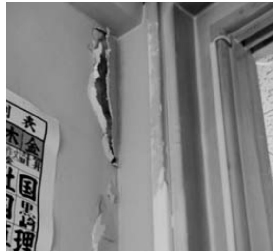
教室の壁に亀裂が入った黒崎小。廊下の壁などにも被害は及びました＝24日午前9時17分
