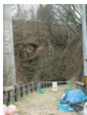
避難路(上写真)を復旧までの間、一時通行止めになりましたので、ご注意ください。
