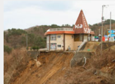
「レストハウスうしお」裏も土砂崩れ (28日、14:00)
