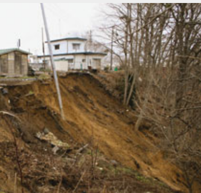
堀内の民家裏もご覧のとおり土砂崩れ (28日、13:17)
