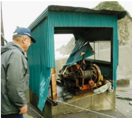
高波で破損した船揚げ機（沢漁港）
