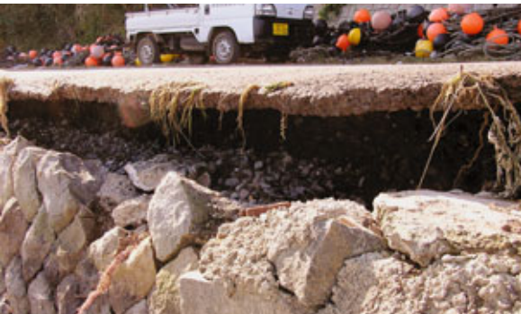
波で道路が削られた堀内港線
