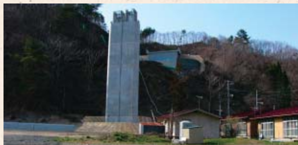
平成18年度の部分開業に向け工事が進む「普代バイパス」写真は普代第1トンネルとA2橋台
