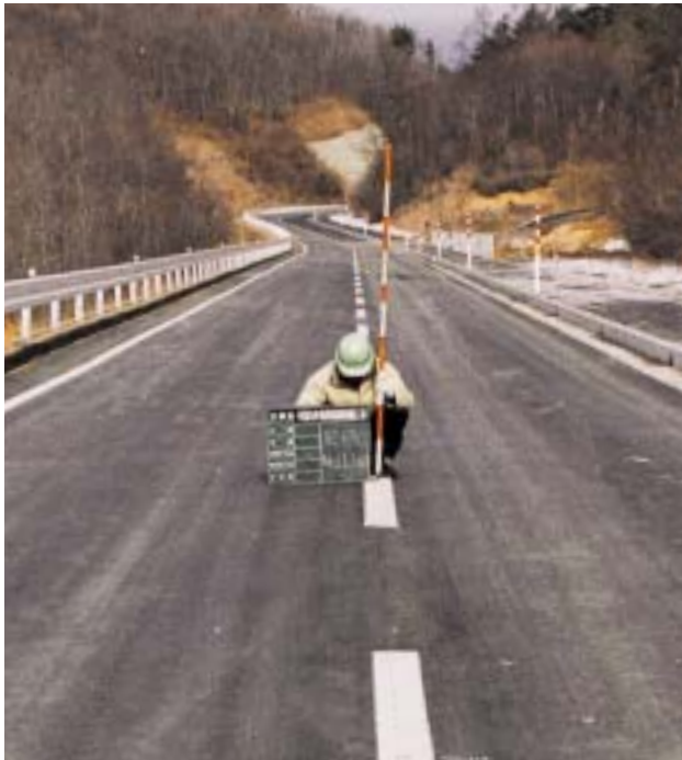
14年度舗装された村道白井鳥居線。(直売所の前から白井方向に向けて1,542.5m) 主な事業のベスト1
