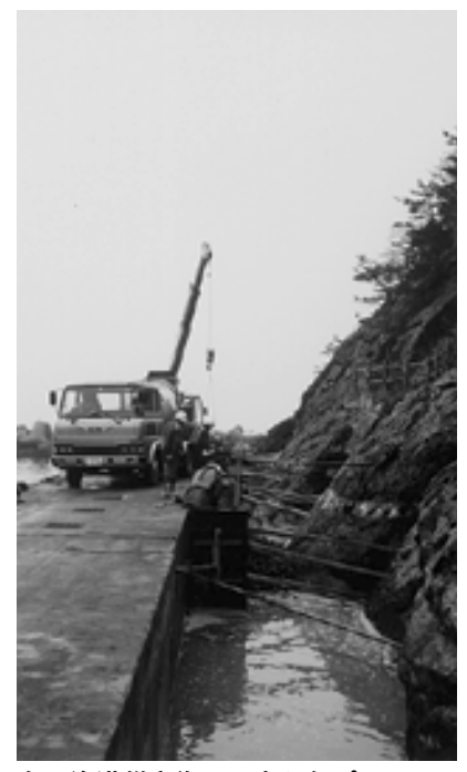
弁天漁港災害復旧工事も急ピッチで進められています
